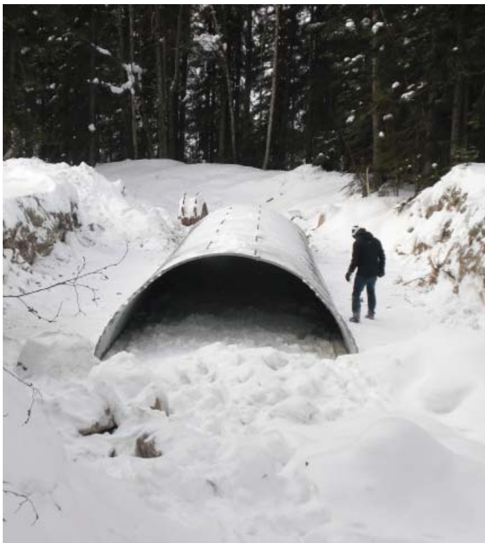
Installation d'un nouveau ponceau à arche sur le ruisseau Monarch gelé afin de rétablir la connectivité aquatique (© Parcs Canada / D. McNamara)
