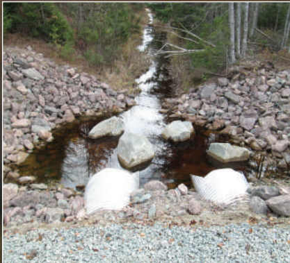
Étangs construits à chaque ponceau pour les poissons et les amphibiens.
