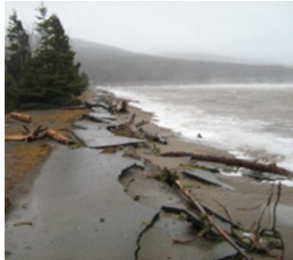
En 2016, la route est de nouveau abîmée. Elle est ensuite enlevée et reconstruite plus loin à l'intérieur des terres, sur pilotis, pour lui permettre de résister aux ondes de tempête et aux inondations.
