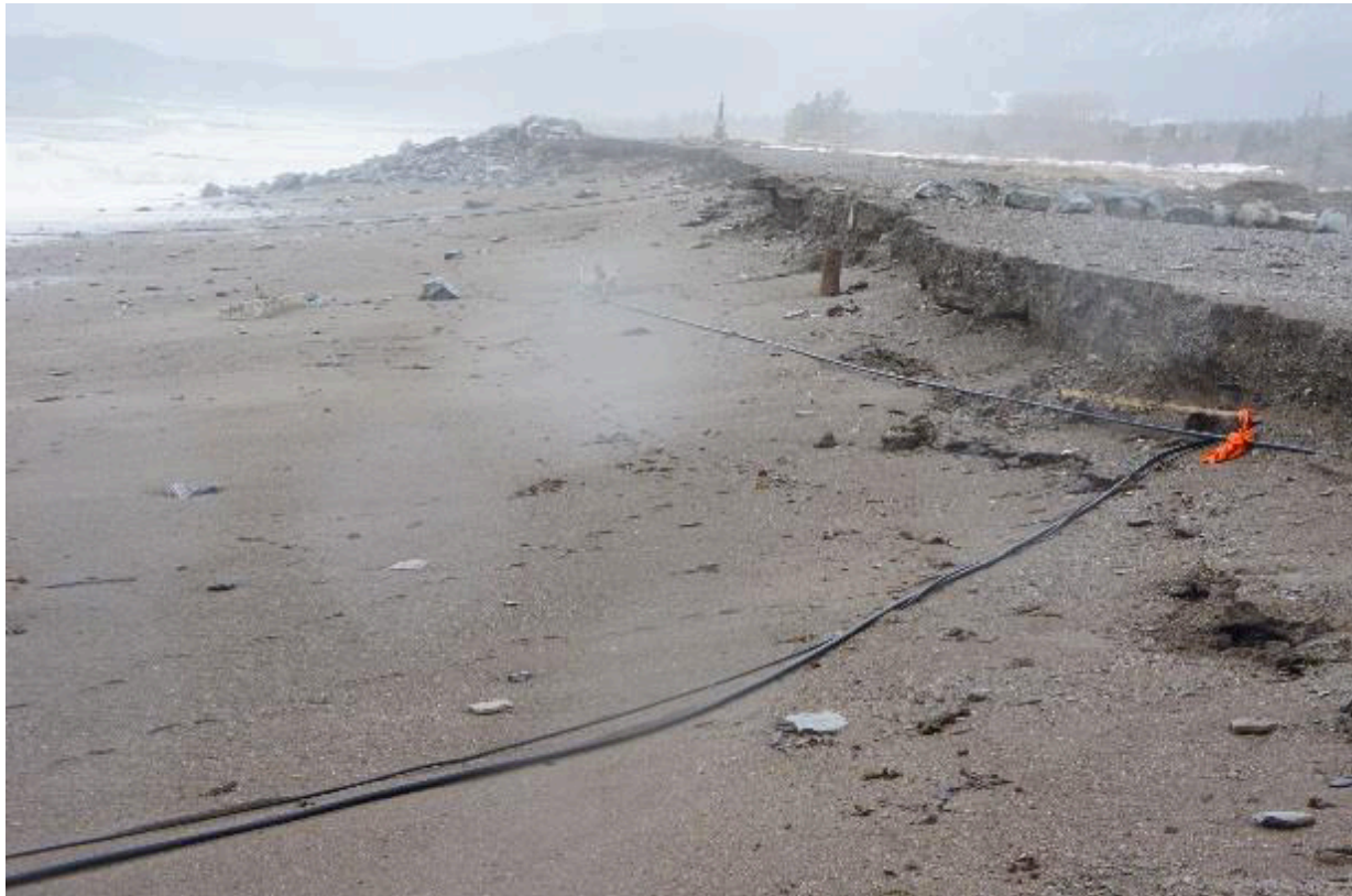
Cap-des-Rosierse, 2011; des dommages causés par la tempête à la chaussée et aux fils électriques souterrains
