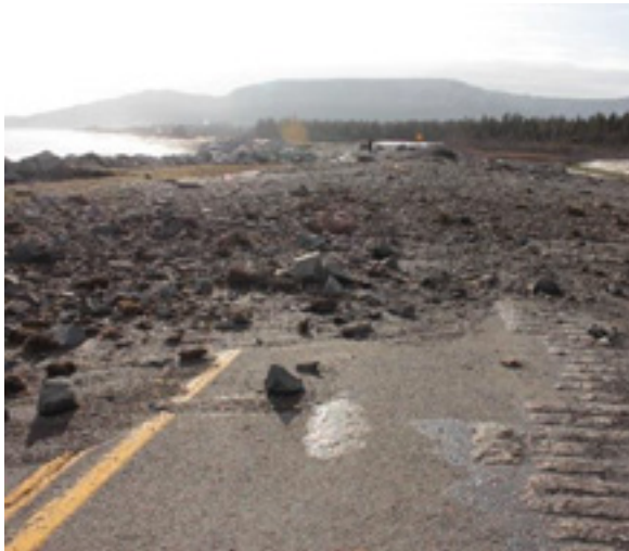
À Penouille, en 2010, deux tempêtes en une semaine ont détruit la route.
